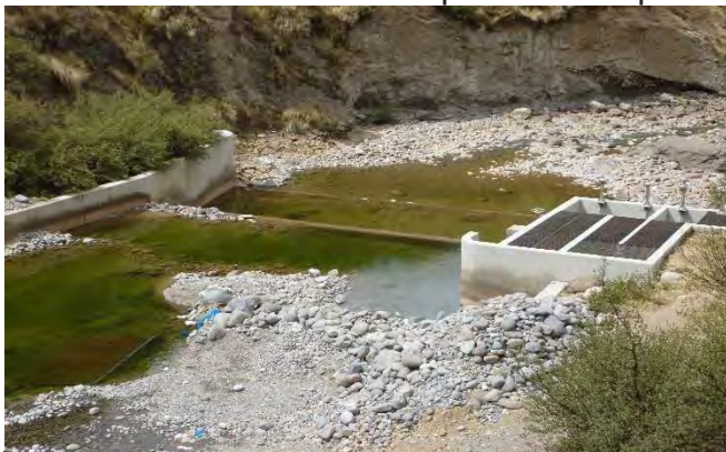
Foto N° 03. Bocatoma del agua potable sobre el río Ichu, poca agua que llega y sigue su curso cuenca abajo. Set. 2017.
